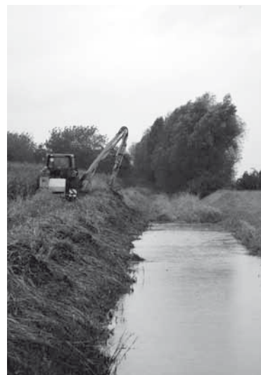
Ohne Fahrstreifen werden die Äcker bei der Grabenunterhaltung beeinträchtigt
